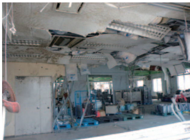
東日本大震災による一般取扱所の被害状況（仙台市消防局提供）
